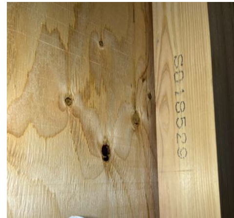
図2：柱とパネルの分離
