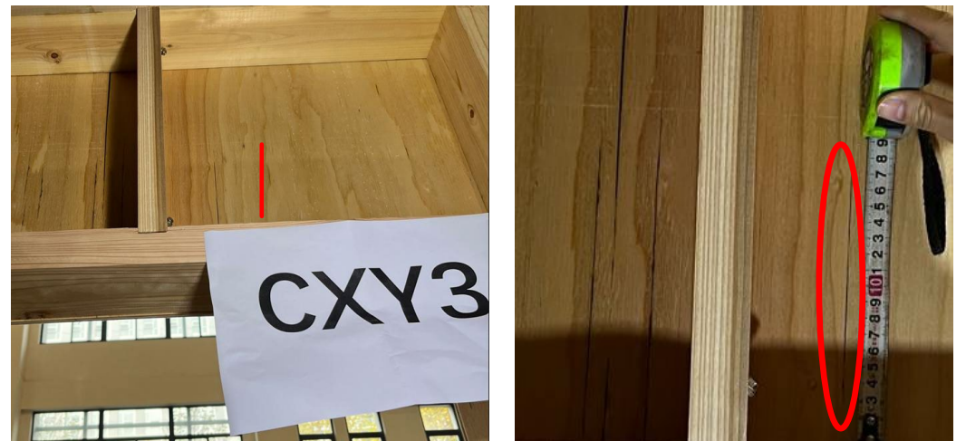
図1：せん断壁パネルの裂け目
