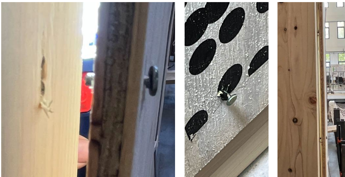
図4：間柱と壁パネルの接合部の釘の引き抜きと切断
