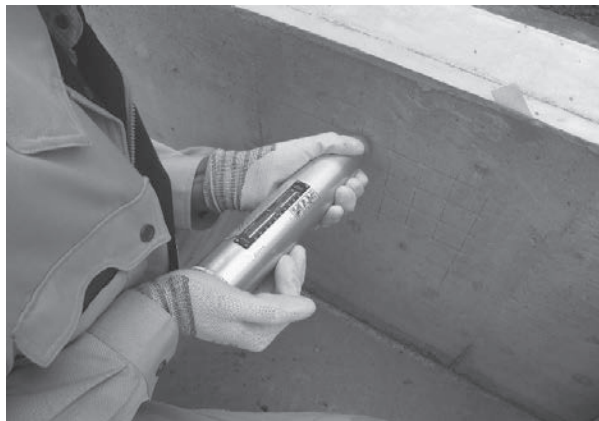
写真 9.15 基礎の検査(シュミットハンマー)
