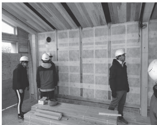
写真 9.44 壁の透湿防水シート
