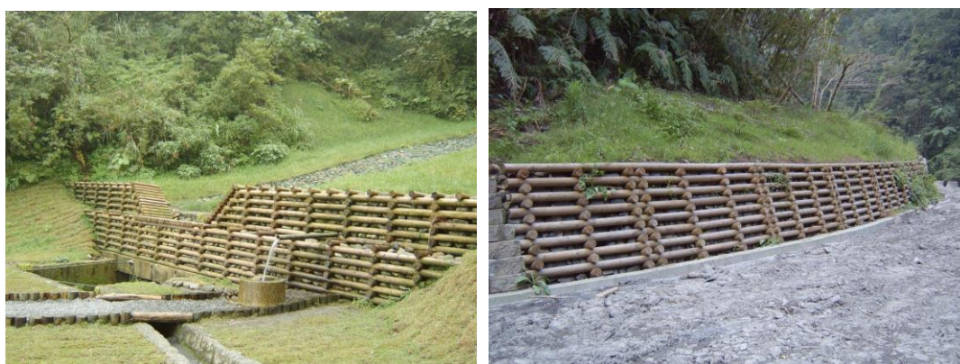
防腐・防蟻処理木材を使用した砂防ダム（左）、擁壁（右）（昆晋実業股份有限公司）
